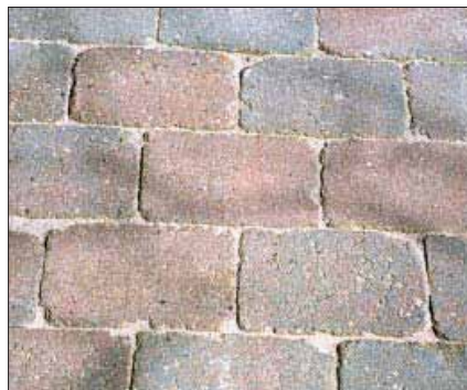
Fugerne skal efterfyldes hvis der mangler fugegrus. Der skal benyttes korrekt fugegrus 5 .
